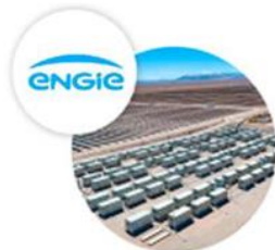
Baterías Bess Coya
